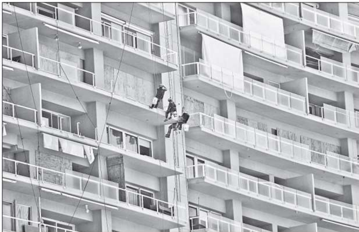
▲ Como parte de la reconstrucción y saneamiento de Acapulco tras el paso del huracán Otis , trabajadores remodelan un condominio en Punta Diamante. Foto Marco Peláez
