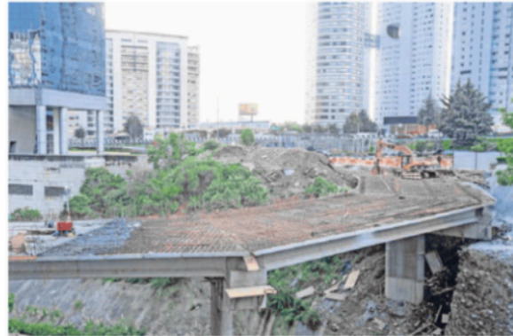
En los trabajos del Tren Interurbano, la ASF detectó también irregularidades en el llenado de los contratos.
