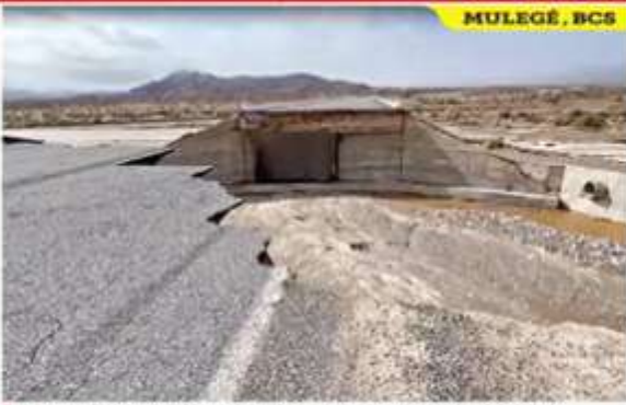
En BCS, el mayor impacto y daños se registraron en Mulegé y Loreto.
