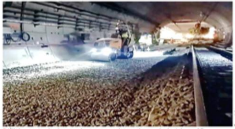
Últimos trabajos en la parte subterránea de la Línea 12 del Metro antes de iniciar los 15 días de pruebas.
