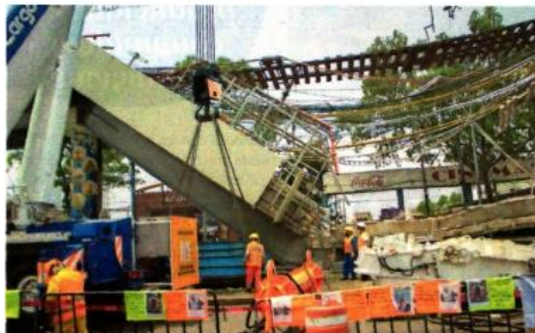
Continúan trabajos peritos nacionales y extranjeros para determinar las causas del colapso del Metro de la línea 12, que corre de Tláhuac a Mixcoac.
