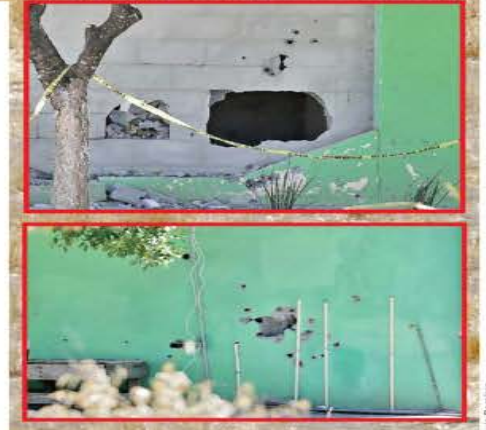
Vestigios del enfrentamiento del 2 de enero en Salinas Victoria, entre un cártel y policías, están a la vista en el rancho El Palmar, donde unidades blindadas estatales destruyeron paredes (1 y 2) y muros quedaron baleados.
