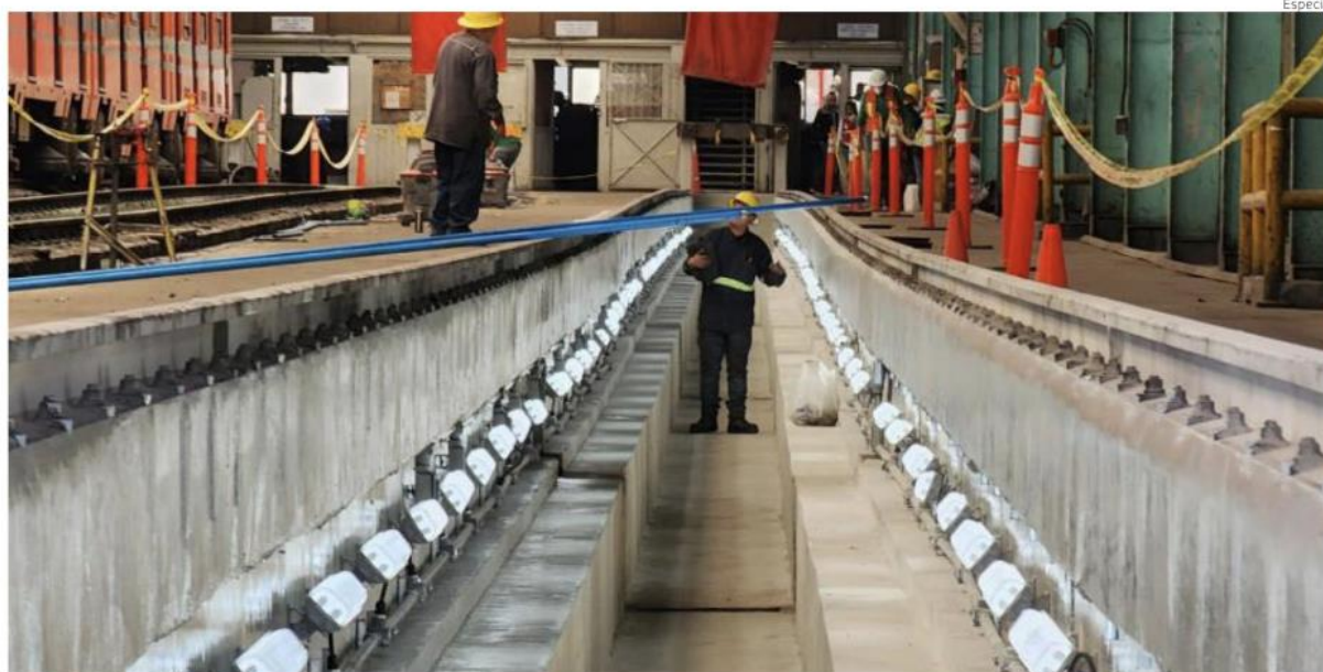
Se entregaron 22 mil 718 piezas de equipo de generación eléctrica, aparatos y accesorios de diferente tipo.
