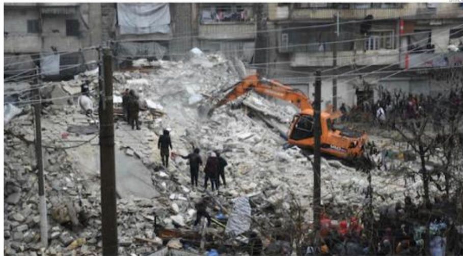
Un edificio derrumbado en la ciudad de Alepo, en el norte de Siria.
