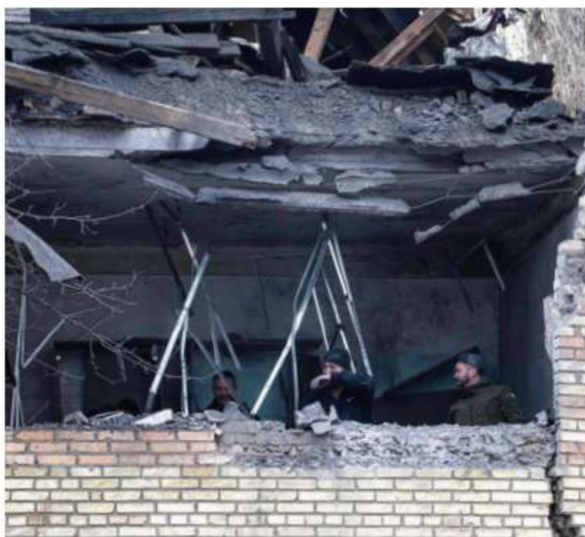
DEFENSORES inspeccionan un inmueble atacado por los rusos en Donetsk, ayer.
