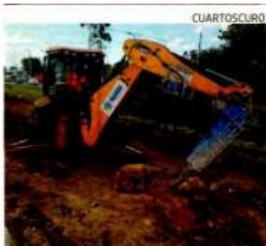
Hay anomalías en las obras.
