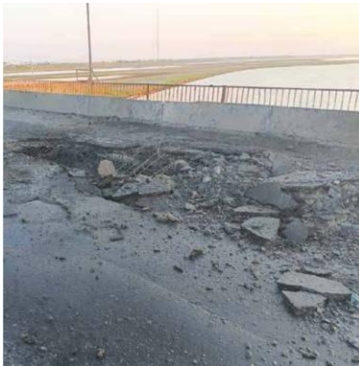
Daño. Un misil impactó en un puente que une Crimea con Jersón, ayer.
