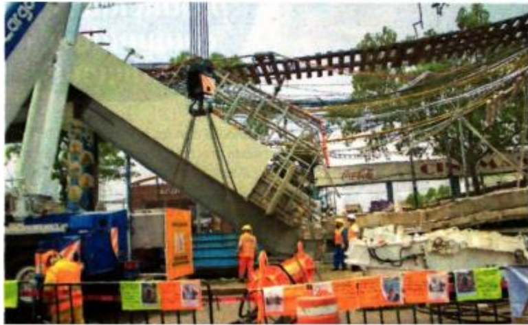
Continúan trabajos peritos nacionales y extranjeros para determinar las causas del colapso del Metro de la línea 12, que corre de Tláhuac a Mixcoac.
