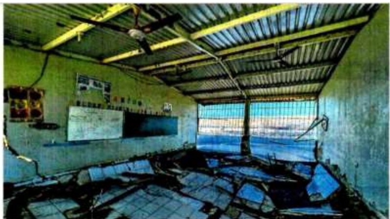
La escuela primaria de la comunidad empezó a ser destruida este mes.
