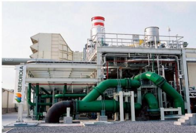
Planta de ciclos combinados Monterrey I y II, uno de los activos.
