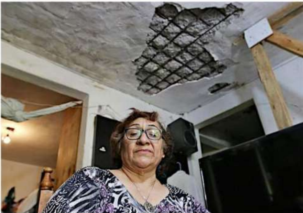
■ En total, 182 viviendas tienen daños por las obras.
