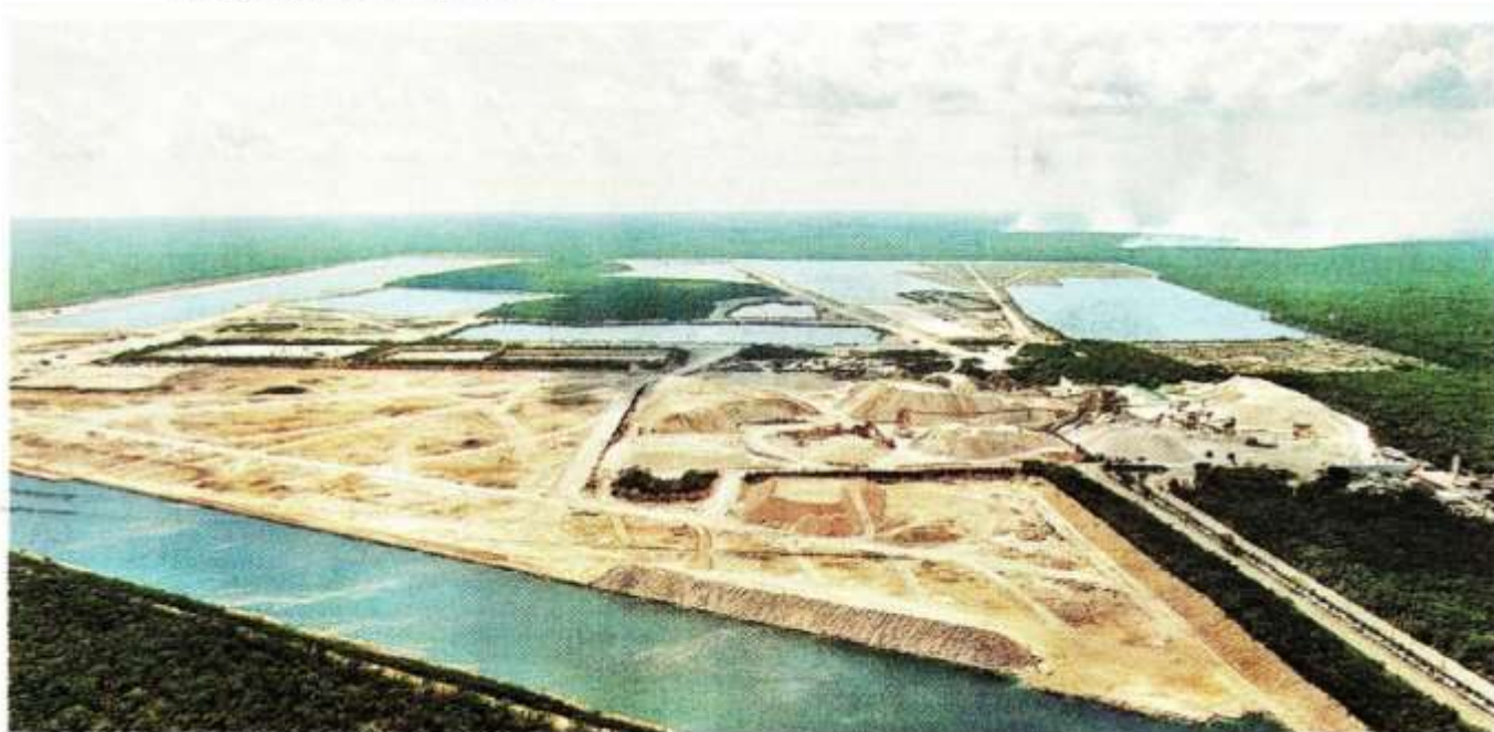
Vista aérea de los terrenos ubicados en Playa del Carmen. FOTOS: ALEJANDRO VARGAS
