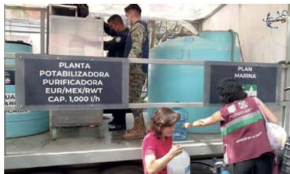
Instalaron dos plantas potabilizadoras con el fin de apoyar a la población afectada.
