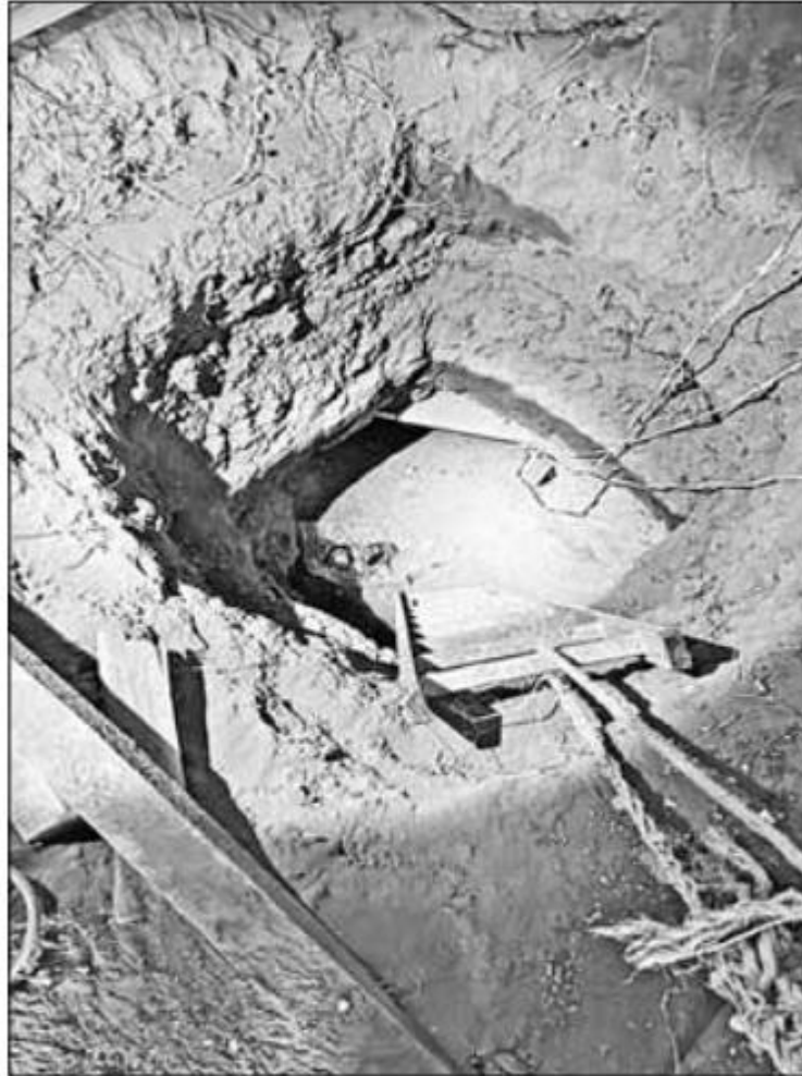
▲ Acceso a un túnel para robo de hidrocarburos hallado por elementos de la Fiscalía General de Justicia y la Secretaría de Seguridad mexiquenses, así como agentes municipales de Acolman en un inmueble de dicha localidad. Foto La Jornada
