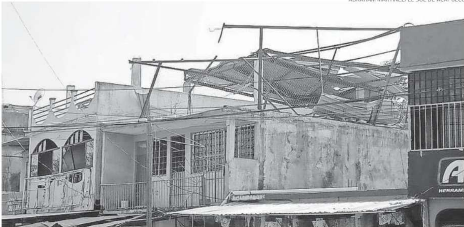
Viviendas sin reparar en la zona suburbana de Acapulco
