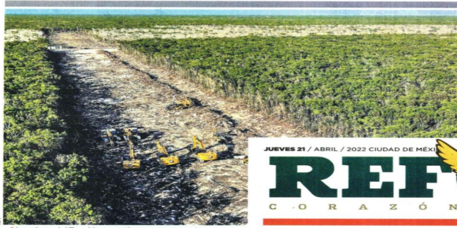
Las obras del Tren Maya continuaron ayer en el tramo Playa del Carmen-Tulum, pese a la orden de un juez para detenerlas.
