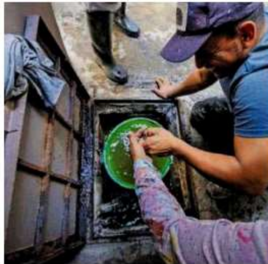
En la desinfección se utiliza cloro
