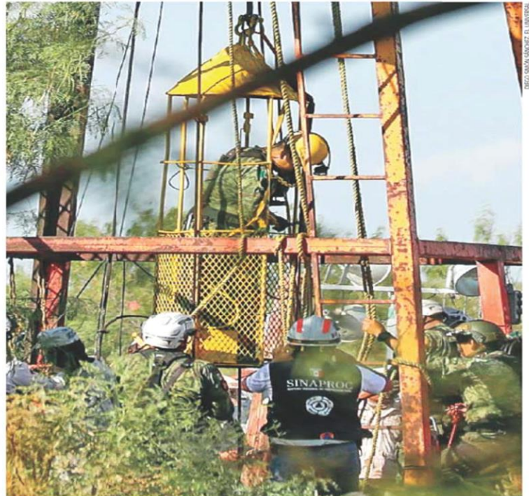
Durante más de tres horas, una canastilla metálica bajó y subió varias veces por el túnel vertical del pozo, con al menos dos militares para verificar las condiciones y retirar los escombros.
