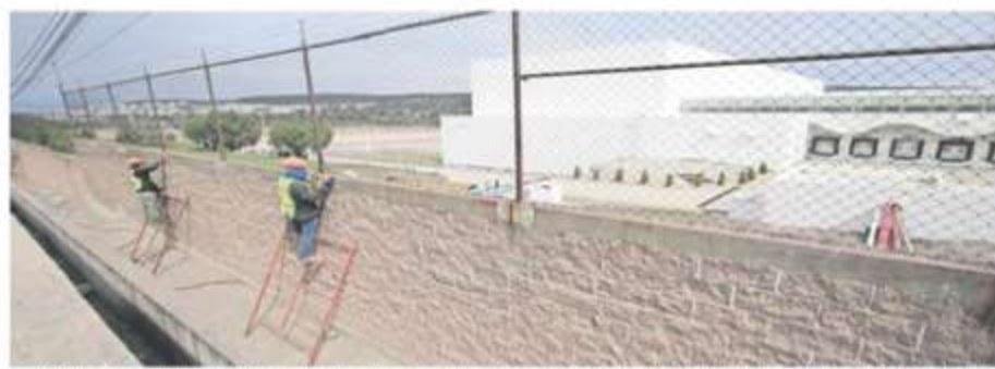
Los trabajos de acondicionamiento se han enfocado en la parte exterior. La fachada ya no tiene la cromática de la tienda departamental a la que perteneció la tienda y ahora está pintada de blanco.
