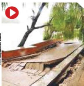
DAÑOS en la obra de Tepetitán, en Tabasco.
