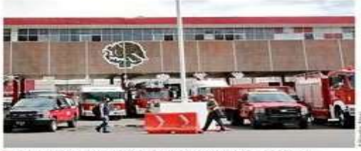
La zona de dormitorios de los bomberos en la Estación Central, tiene daños estructurales desde el 19S.
