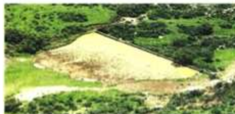
La mayoría de las presas en Ecatepec, que contienen los torrentes que bajan de la Sierra, están en malas condiciones.
