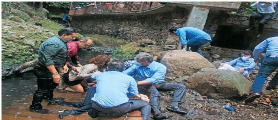
Cuernavaca.— El alcalde José Luis Urióstegui y 20 personas de su comitiva resultaron lesionados por el desplome del puente colgante en el Paseo Ribereño. La estructura fue rehabilitada el año pasado con 20 mil pesos, al quedar fuera del presupuesto para mejoras. | ESTADOS | A18
