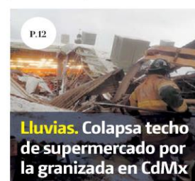
Lluvias. Colapsa techo de supermercado por la granizada en CdMx
