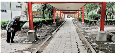
Corredores en mal estado y jardineras descuidadas evidencian el deterioro de la unidad habitacional.
