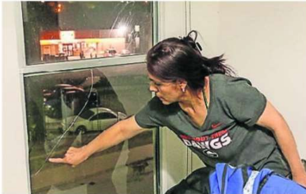
La señora Jade muestra un vidrio roto de su vivienda. Asegura que sucedió por las explosiones en la obra. También tiene paredes resquebrajadas.
