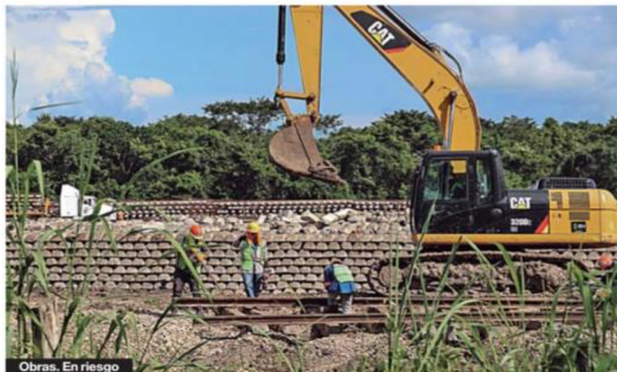
Obras. En riesgo
