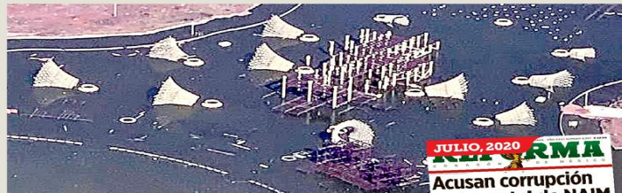
En el Lago de Texcoco siguen los foniles y las estructuras de acero que la empresa "Gilbert Estructuras" no pudo sacar.
