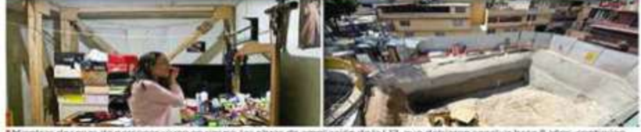
Mientras decenas de personas viven en riesgo, las obras de ampliación de la LT2, que debieron concluir hace 8 años, continúan.
