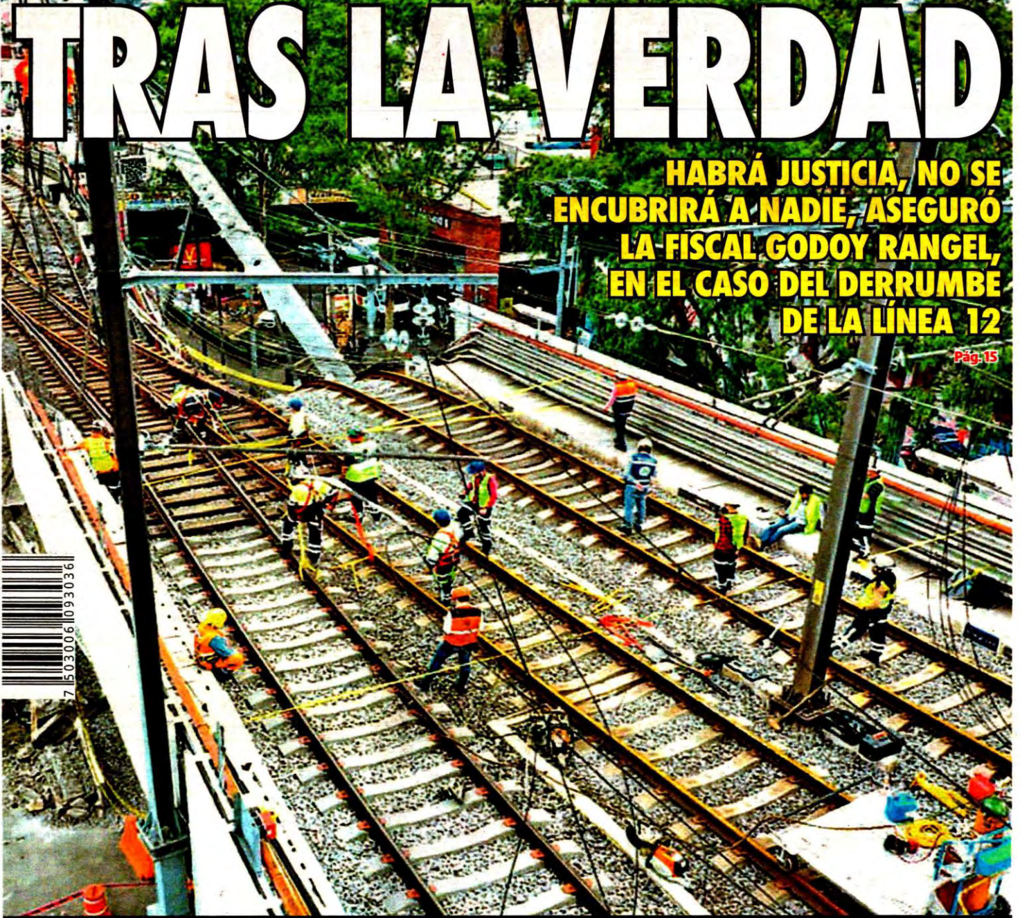
Peritos laboran en la zona cero del colapso de la Línea 12. FOTO DAVID DEOLARTE
