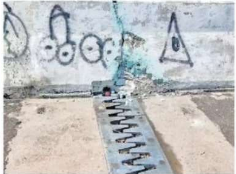
Debido a la falta de mantenimiento, la obra se encuentra deteriorada en algunas partes.
