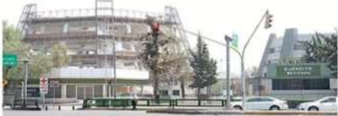
Los trabajos en la Colonia Irrigación iniciaron desde el pasado 10 de abril.
