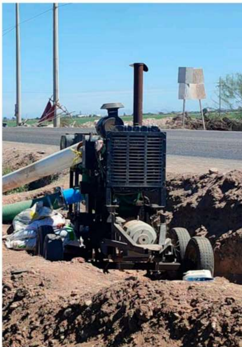
Perforación de tuberías para rebompear el agua a otras zonas, un delito que sigue en aumento
