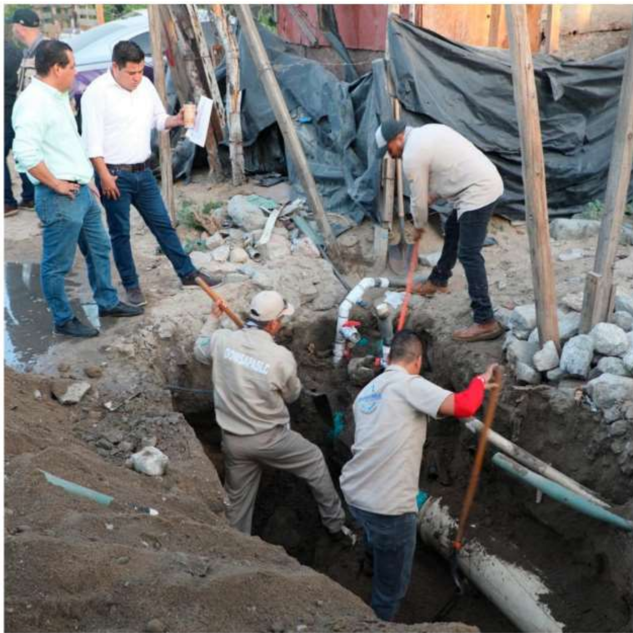
Toma clandestina detectada y Clausurada en Los Cabos, Baja California
