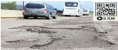
Las obras del Tren Maya dejaron casi mil kilómetros de carreteras dañadas, según datos de la SICT.
