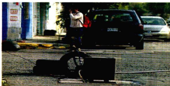
En la red hidráulica se han detectado tomas clandestinas en las que se instalan mangueras y bombas para llevar el agua a puntos de almacenaje.
