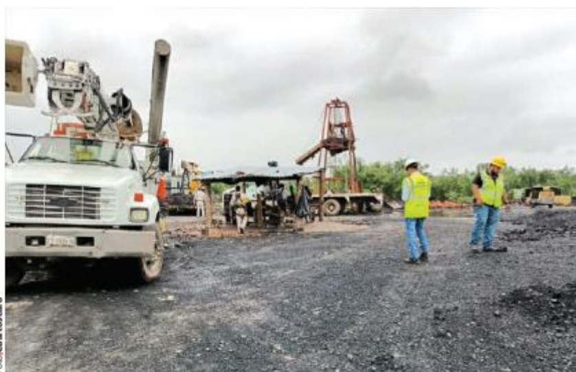
CNPC Y CFE iniciaron ayer la nueva fase de una excavación de 50 metros de profundidad.
