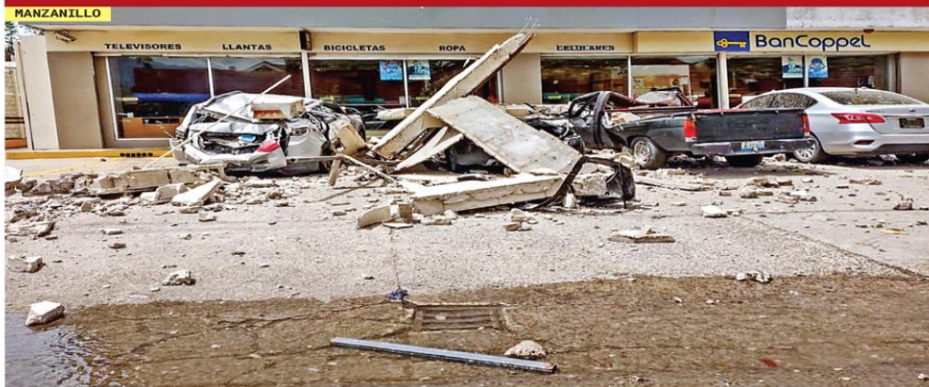
Parte de la fachada de una tienda departamental en Manzanillo, Colima, se desprendió y cayó encima de un hombre, el cual falleció. Foto: Especial
