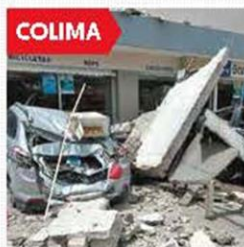
MANZANILLO. Los derrumbes y colapsos causaron dos muertes.
